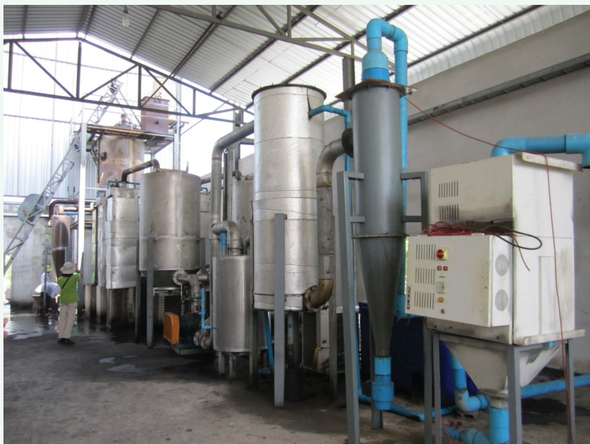
เครื่องผลิตพลังงานจากเชื้อเพลิงชีวมวล
