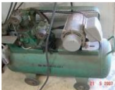
เครื่องปั๊มลม
