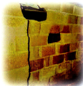
สำรวจตามรอยแตกของผนัง ด้านนอกอาคาร
