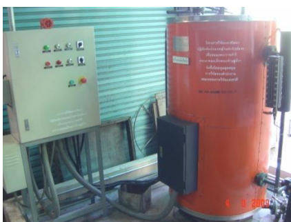
ภาพที่ 1 เครื่องกำเนิดไอน้ำ
